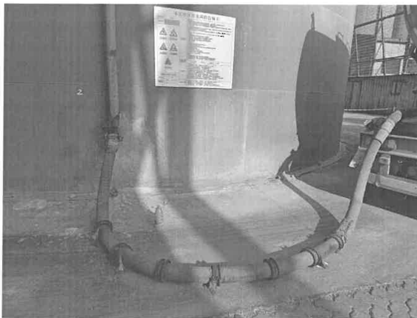
图 5 现场卸料管未拆除
